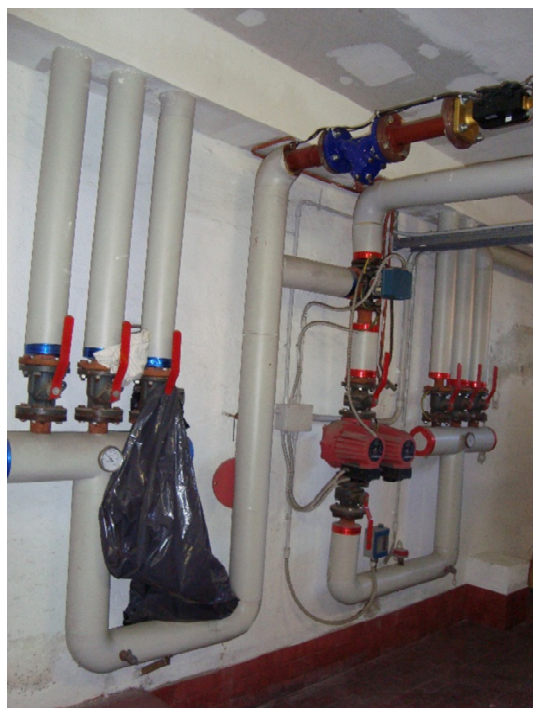
Figura 4.7 - Particolare dello stacco di mandata al collettore principale e valvola a tre vie
