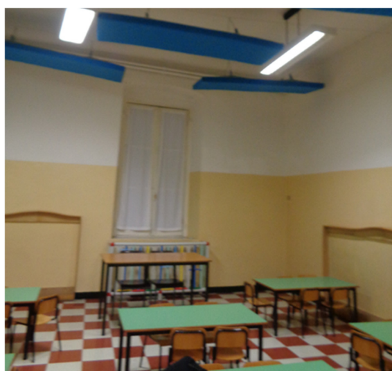
Figura 4.16 - Particolare dei corpi illuminanti ubicati nelle aule
