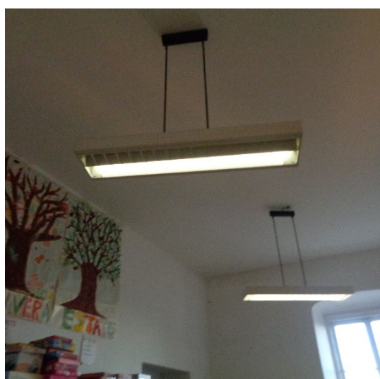
Figura 4.15 - Particolare dei corpi illuminanti ubicati nella mensa
