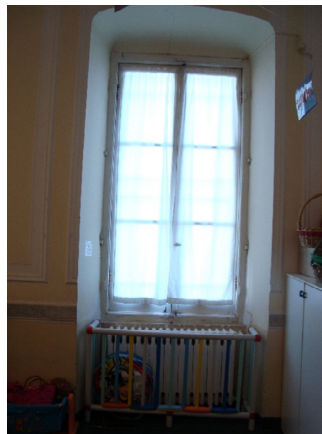
Figura 4.6 - Particolare radiatori su parete esterna
