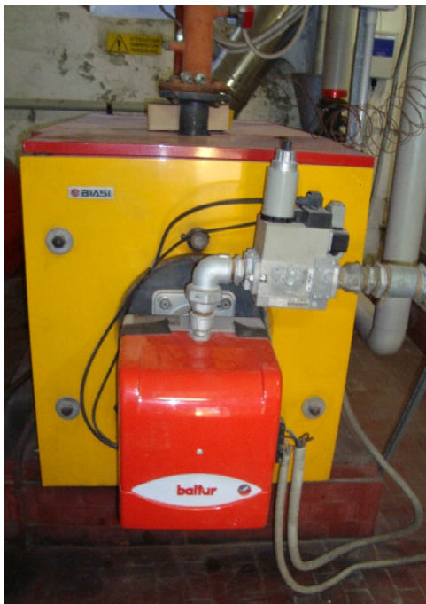
Figura 4.11 - Particolare generatore di calore
