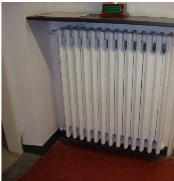
Figura 4.5 – Particolare radiatore su parete interna
